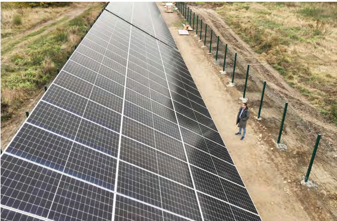
Die ukrainische NGO Ecoclub installiert Solarkraftwerke, insbesondere für zivile Infrastruktur wie Krankenhäuser oder Wasserwerke. Foto: Ecoclub
