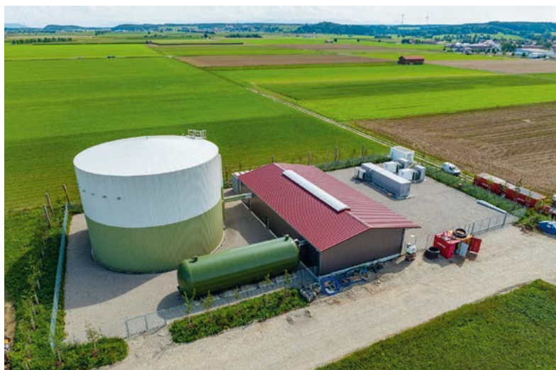
Heizzentrale in Fuchstal mit Biogasanlage und Wärmespeicher.
