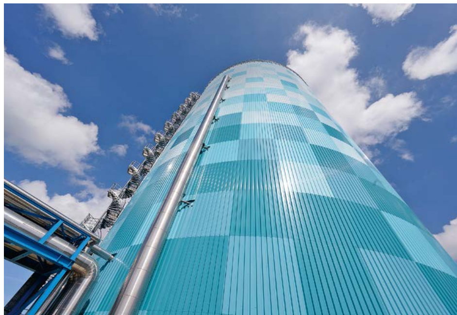
Der große Wärmespeicher ist ein Meilenstein auf dem Weg zur klimaneutralen Fernwärme in Rostock.
